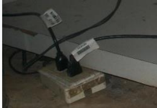
Conexiones sin protección y base, ni debidamente identificado en zona de riesgo de humedad.
