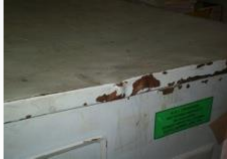
Equipo de mobiliario dañado, no cierra bien por su desgaste.
