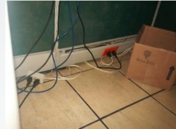
Cableado desbordándose de la caja y sin estar acomodado
