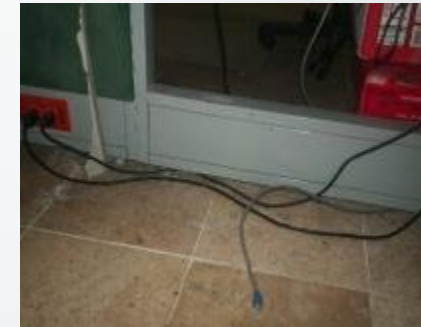
Sin plafón y cableado mal seccionado.
