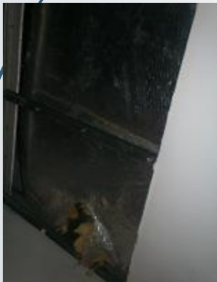
Plafón en techo roto.
