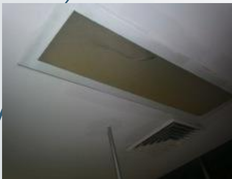
Protector de lámpara dañado.
