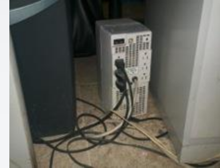
Cableado fuera de lugar designado.
