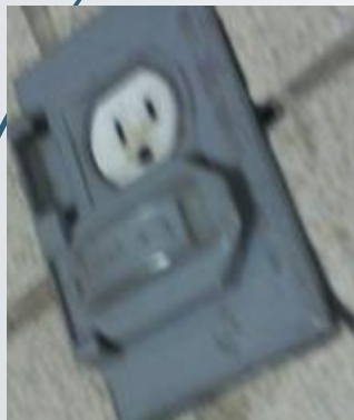
Falta la cubierta en uno de los protectores para la toma de corriente.
