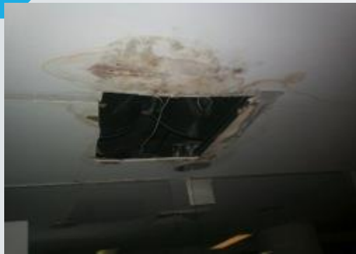
Techo de plafón desprendido por humedad.
