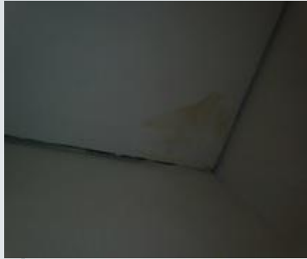
Humedad y grietas.
