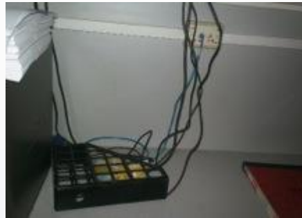
Cableado sin acomodar y objetos de oficina fuera del área.
