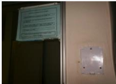
Dispensador de jabón roto.
