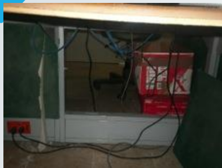
Cableado en desorden y falta de plafón.
