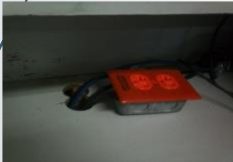
Conexiones sin protección en zona de riesgo de humedad.
