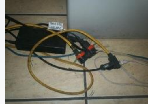
Cableado fuera de lugar y desordenado.
