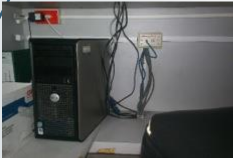
Cableado sin acomodar ni debidamente identificado.
