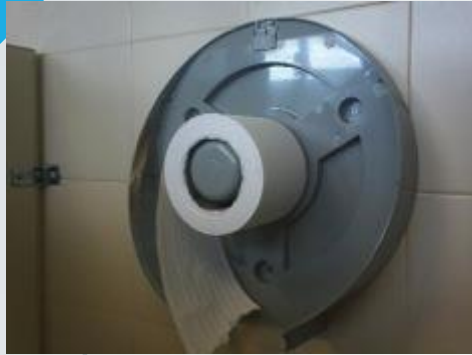
Falta de la cubierta en el dispensador de papel.
