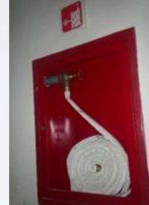
Manguera contra incendios sin debida protección.
