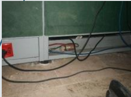
Sin tapa para protección de corriente y cables sin acomodar.
