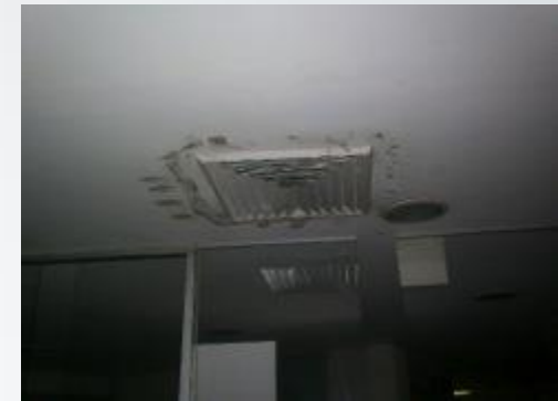
Techo de plafón sucio y con residuos de maskin.
