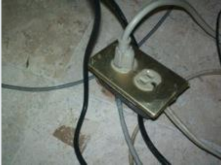
Cableado fuera de lugar designado.
