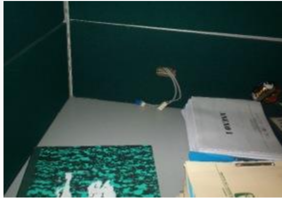
Cableado sin protectores, ni uso real para el trabajo.
