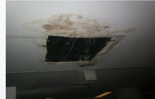
Conducto de aire acondicionado con riesgo a descargas eléctricas por goteras.
