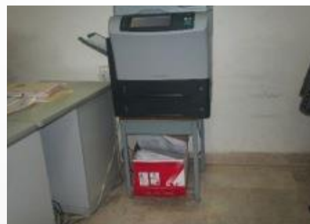
Cableado desordenado y documentos sin lugar designado y marcado.
