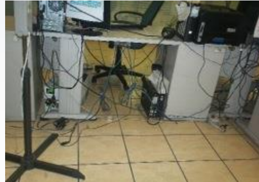
Cableado sin acomodar, ni debidamente identificado y sujetado.
