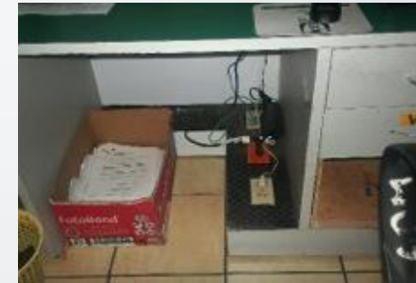
Cableado, contactos sin acomodar y archivos sin acomodar.
