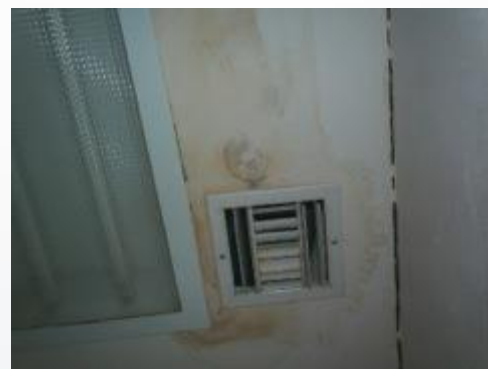
Techo de plafón sucio por humedad.
