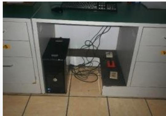
Cableado estorbando, con posibilidad de crear accidentes.
