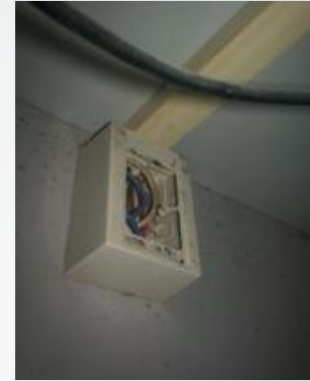
Cableado sin protección, ni debidamente identificado en zona de riesgo por humedad.
