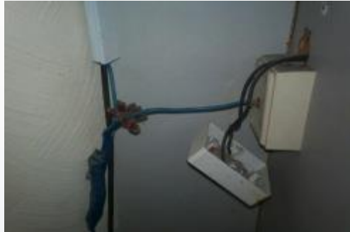
Cableado sin protección, ni debidamente identificado.
