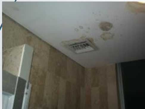
Techo de plafón sucio por humedad.
