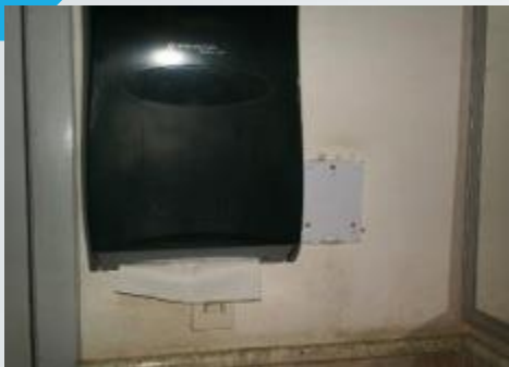
Dispensador de jabón roto.
