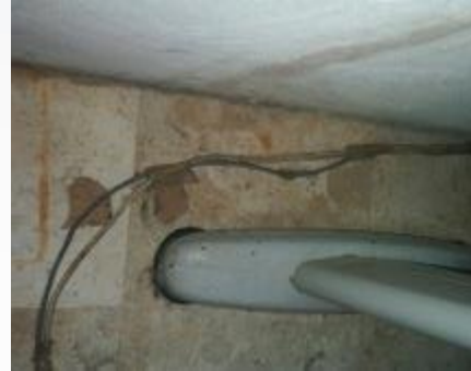
Cableado fuera de lugar designado.
