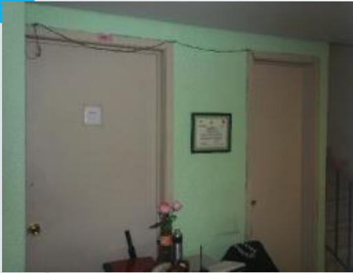
Cableado sin protectores, ni perfectamente sujeto.
