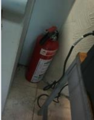
Extintor fuera de lugar designado.
